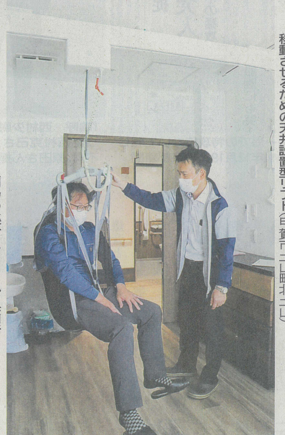
「あいの土山福祉会」が運営する特別養護老人ホームに導入された利用者を移動させるための天井設置型リフト(甲賀市土山町北土山)
